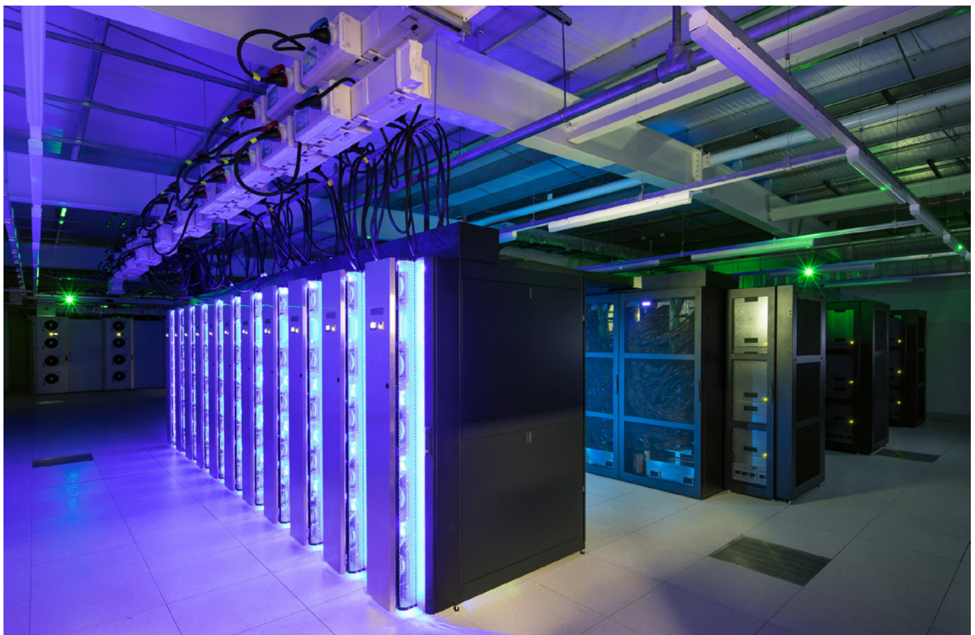
Met Office Exeter Data Centre, UK
